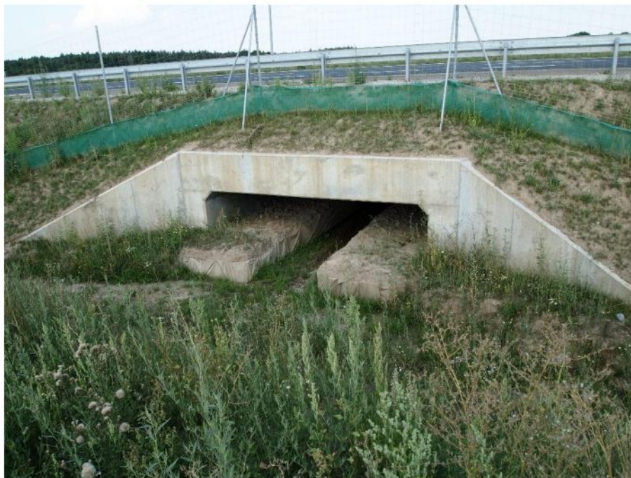
Rysunek 3 Przejście dla zwierząt o funkcji eko i hydrogeologicznej dla płazów w km 187+460 autostrady A1 Źródło: fotografia własna
